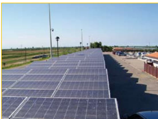
Pensiline sui parcheggi Porto Barricata, Comune di Porto Tolle (RO)
