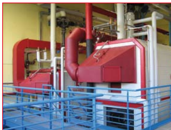
Caldaie a biomassa della centrale di Teleriscaldamento di Prato allo Stelvio
