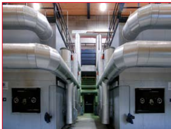
Impianto di teleriscaldamento da biomassa - Sesto (Bz)
